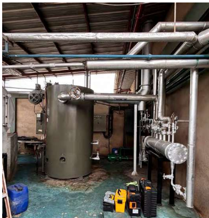
Figura 4 Sistema de generación de vapor con caldera pirotubular ubicado en Guayaquil, empleado como base para el levantamiento de datos y análisis experimental.
